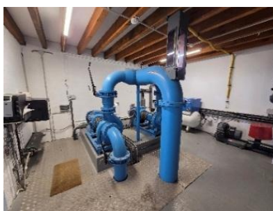
Figure 4 : canalisation à la sortie du réservoir (photo CE)
